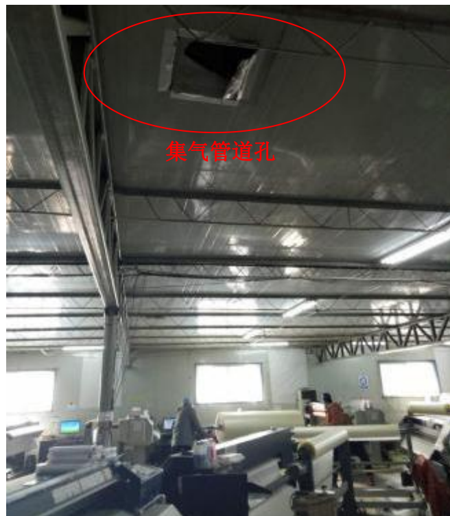
图 3-5 打印、复合集气上方集气管道
