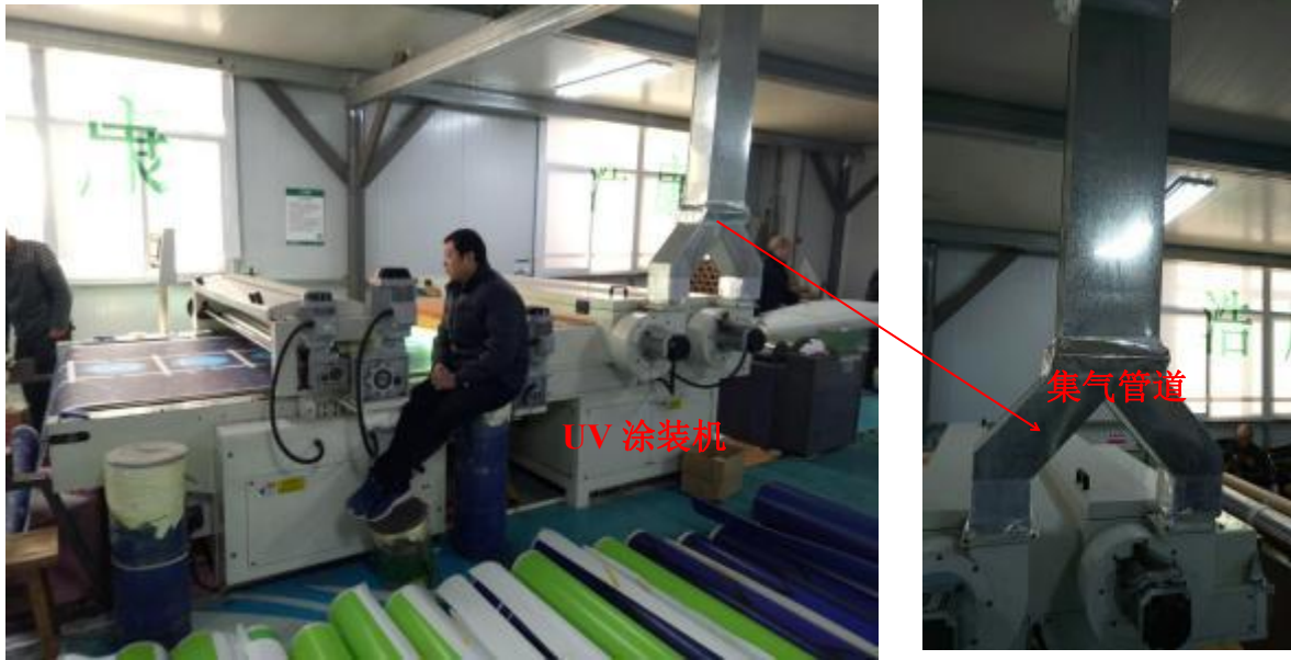
图 3-4 UV 涂装级集气管道
